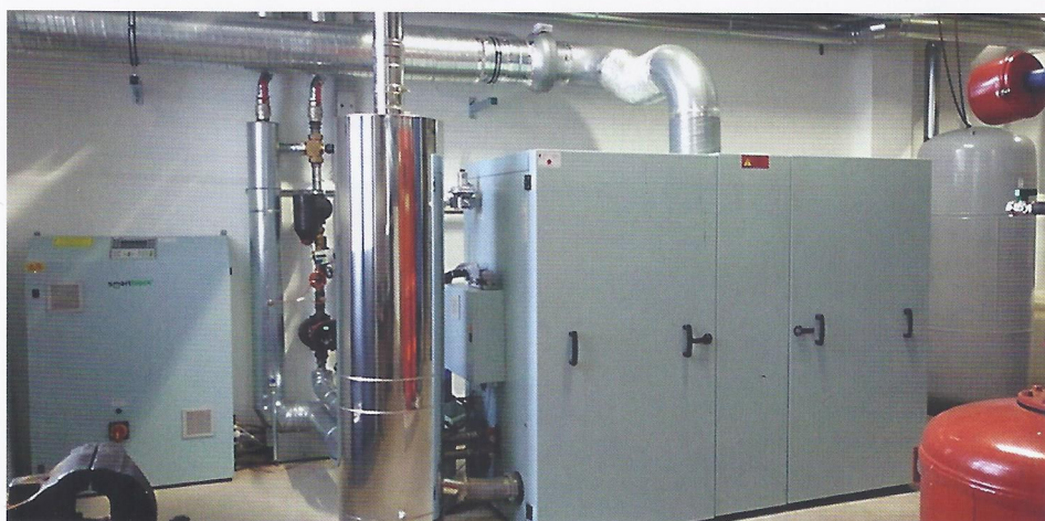
Kleines Kraftpaket – das Blockheizkraftwerk hat 2018 42% der benötigten elektrischen Energie und 53% der Wärmeenergie geliefert.
